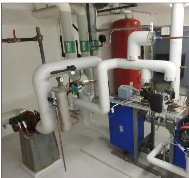
Fjärrvärmewäxlare samt injusteringsventiler
