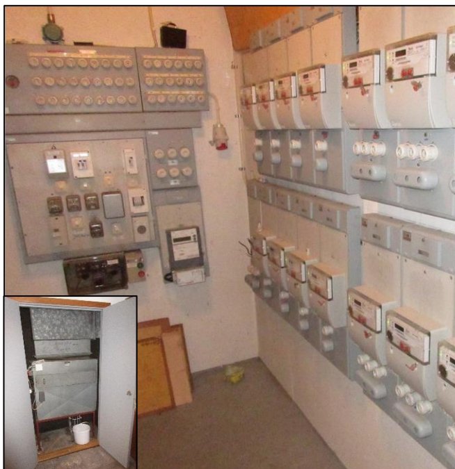
El-central i källare samt fläkt.
