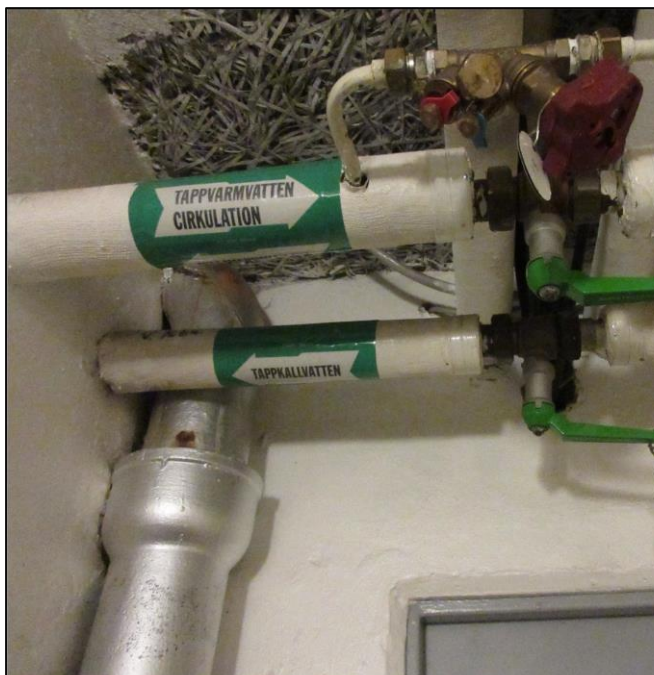
Tappvattenventiler samt spillvattenledning
