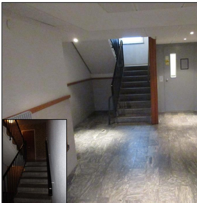
Trapphus med hiss samt urkopplade fläktar.
